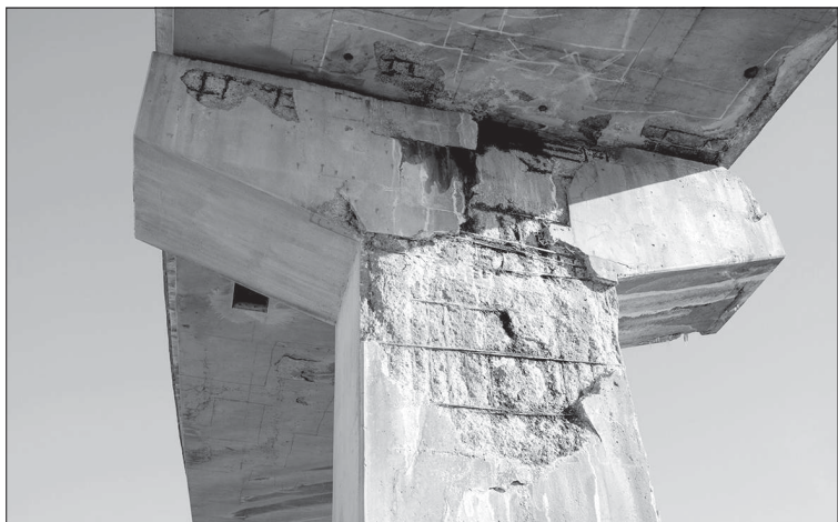
Коррозия — враг строительных конструкций
