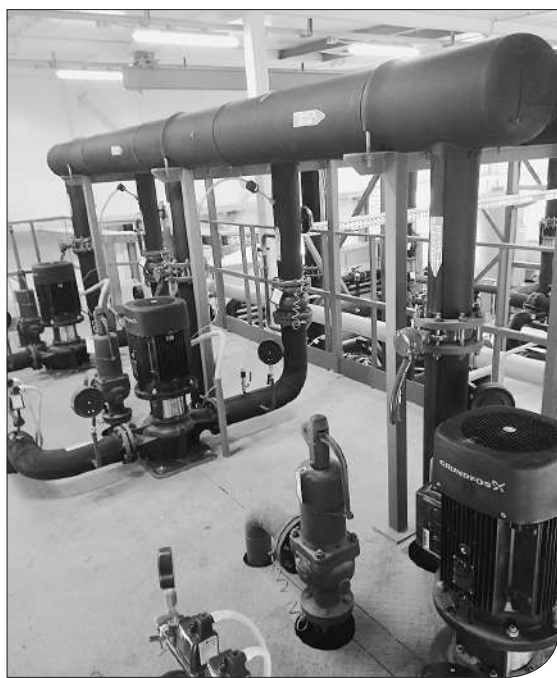
Котельная «Клён» в Задонском районе
