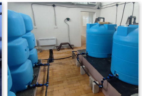
Насосная станция, г. Елец
